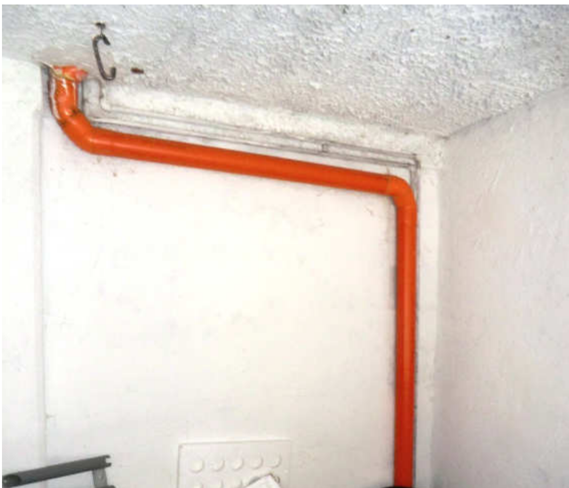
Foto n. 21 - Tubazioni passanti nel garage
